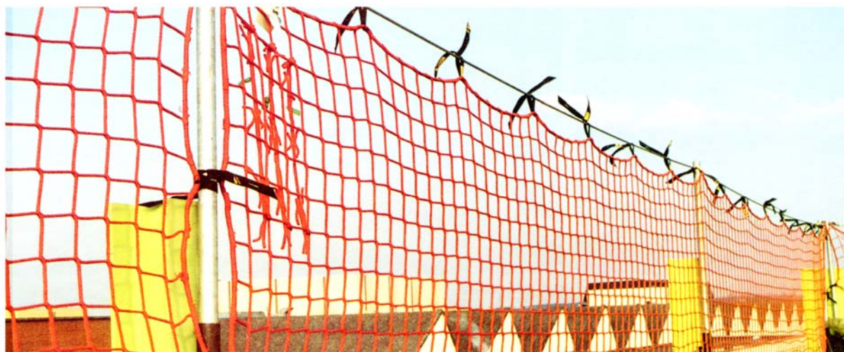
Exemple d'une protection antichute latérale avec les filets garde-corps montés sur supports universels.
